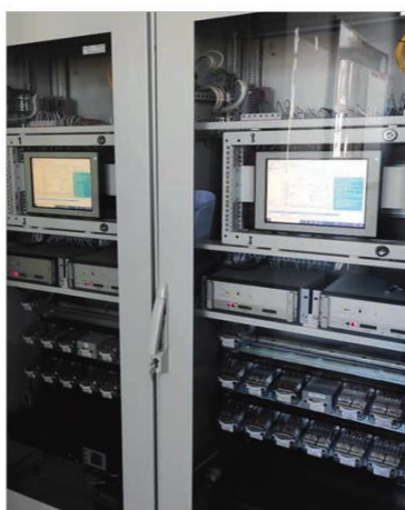
Шкаф МПБ на участке Никельтау – Кандыгаш (Казахстан)
